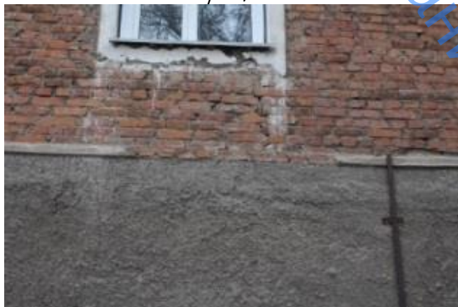
Фото 55. Трещина в стене
