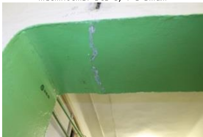
Фото 16. Трещина в стене, обеспечивающей пространственную жесткость. Ось 5, 1-й этаж
