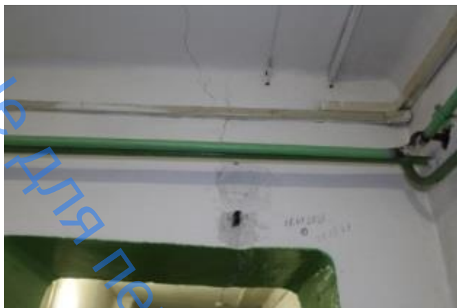
Фото 13. Трещина в стене, обеспечивающей пространственную жесткость. Ось 5, 1-й этаж
