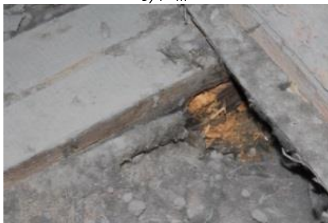
Фото 40. Контрольная врубка балок перекрытия второго этажа. Глубокое поражение гнилью в осях 2-8/Г-Ж
