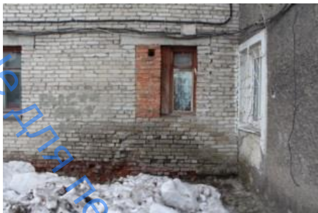
Фото 51. Выветривание наружной версты кладки на глубину 120-200 мм Фасад по оси 7.
