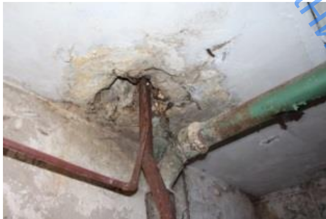
Фото 11. Разрушение защитного слоя бетона перекрытия подвала
