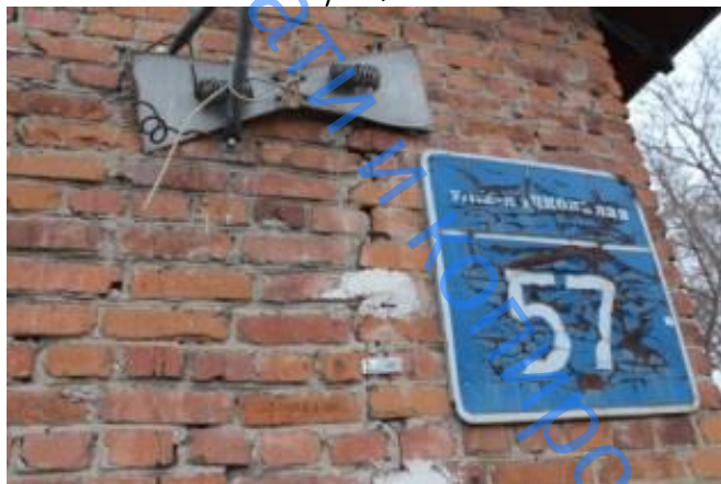
Фото 59. Трещина в стене
