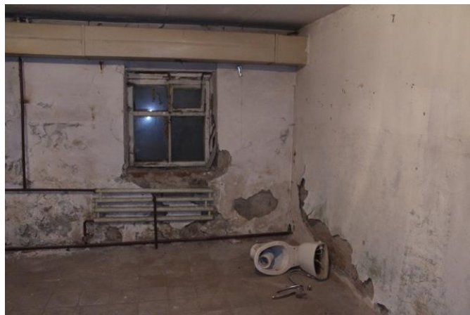
Фото 2. Следы замачивания стен подвала по оси 9
