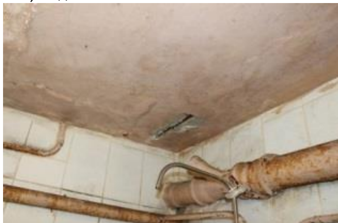
Фото 22. Коррозия рабочей арматуры перекрытия первого этажа
