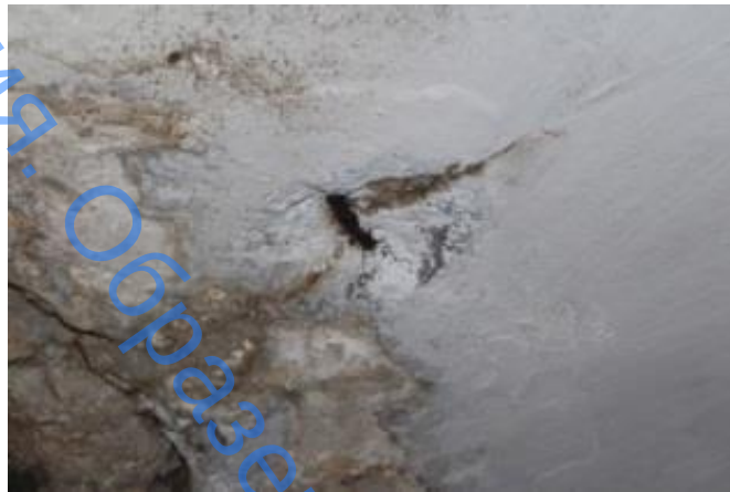
Фото 12. Коррозия рабочей арматуры перекрытия подвала
