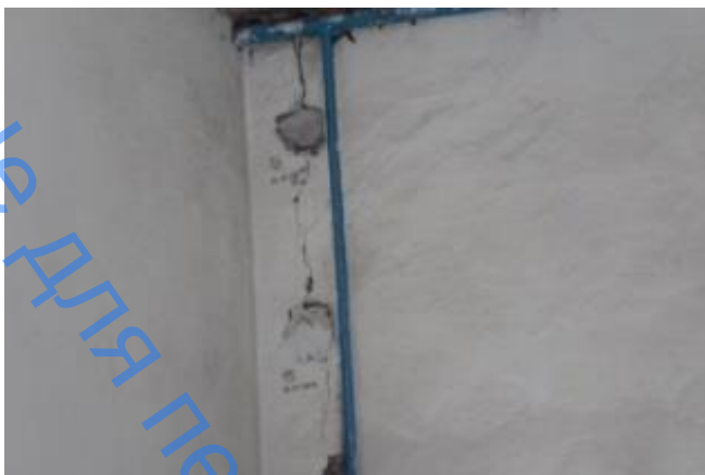
Фото 31 Трещины по деформационному шву
