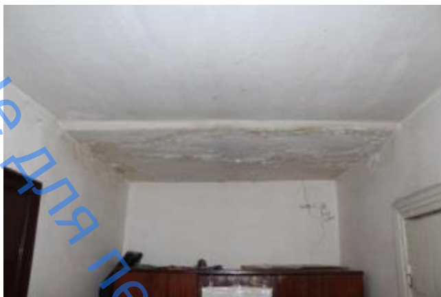
Фото 37. Протечки перекрытия 2-го этажа
