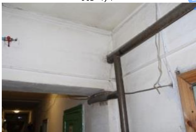
Фото 29. Трещина в стене, обеспечивающей пространственную жесткость. Ось 5, 2-й этаж
