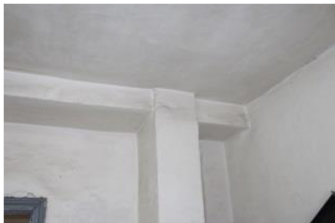
Фото 28. Трещина в колонне ось 4/Д
