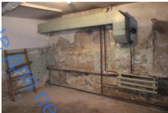
Фото 7. Следы замачивания стен подвала по оси 9
