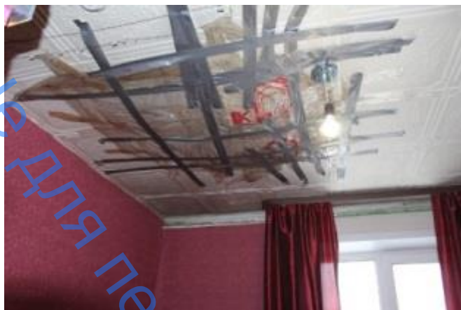
Фото 25. Частичное обрушение перекрытия второго этажа в осях 3-4/Г-Д
