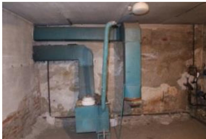
Фото 10. Следы замачивания стен подвала по оси 9
