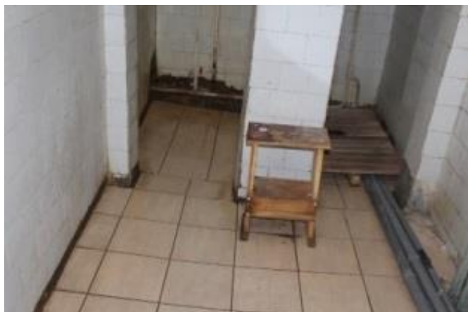
Фото 20. Просадка полов, 1-й этаж в осях 8-9/Г-Д
