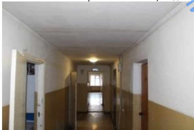
Фото 35. Разрушение рустов перекрытия 2-го этажа
