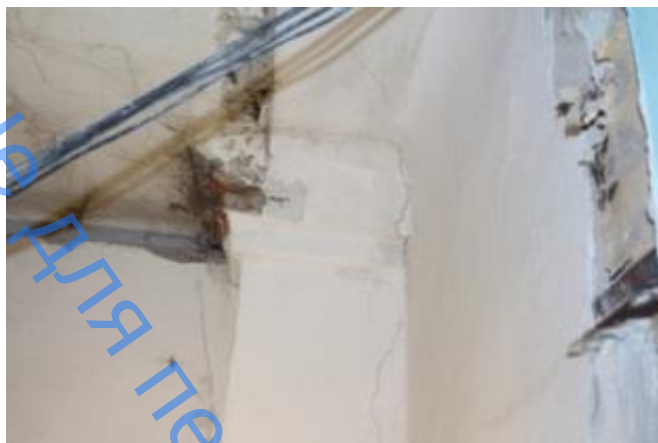
Фото 19. Трещина в колонне. Ось 4/Е, 1-й этаж
