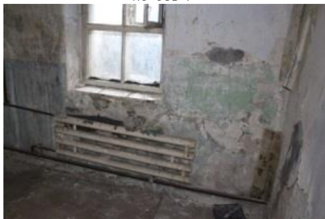
Фото 4. Следы замачивания стен подвала по оси 7
