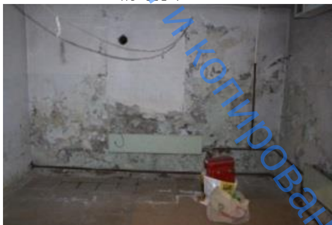
Фото 3. Следы замачивания стен подвала по оси 7
