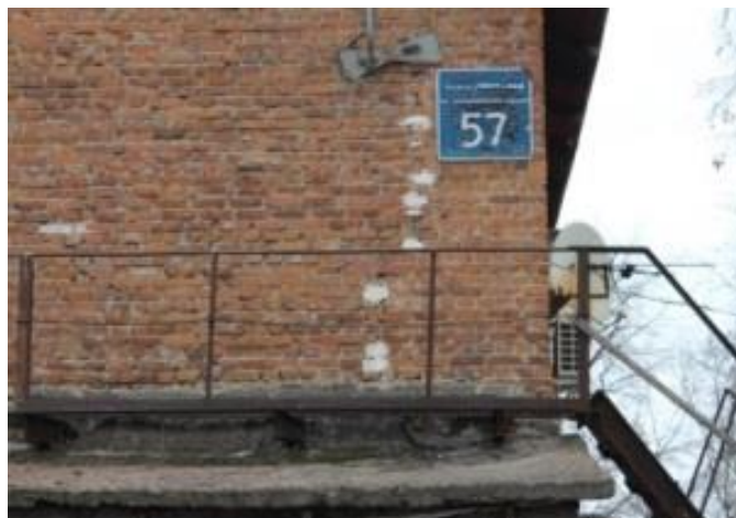
Фото 58. Трещина в стене
