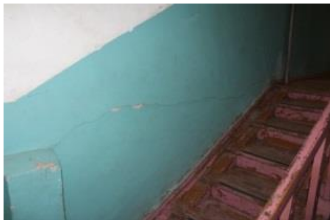
Фото 32. Разрушение перегородки, вызванное осадкой несущих конструкций ось 4/Г
