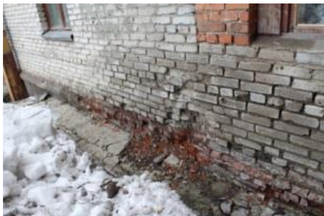
Фото 52. Выветривание наружной версты кладки на глубину 120-200 мм Фасад по оси 7.
