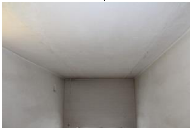
Фото 34. Разрушение рустов перекрытия 2-го этажа
