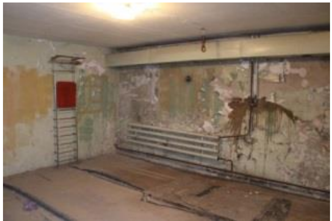
Фото 5. Следы замачивания стен подвала по оси 9
