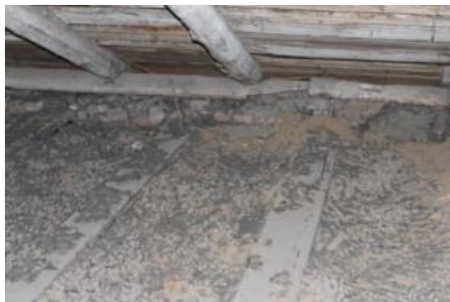
Фото 38. Разрушение кладки стен в местах опирания мауэрлатов в осях 2-8/Г-Ж
