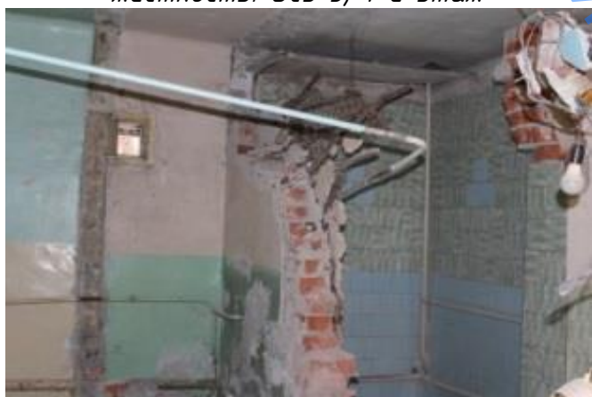
Фото 17. Просадка полов, обрушение перегородок. 1-й этаж в осях 4-5/Е-Ж
