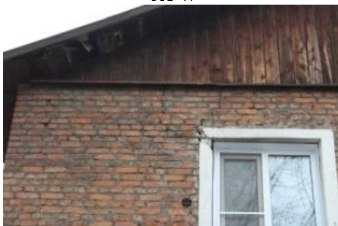
Фото 54. Трещина в стене
