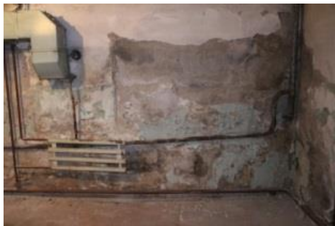
Фото 8. Следы замачивания стен подвала по оси 9
