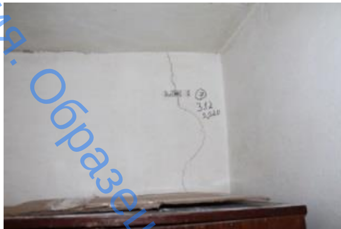
Фото 36 Трещины по деформационному шву
