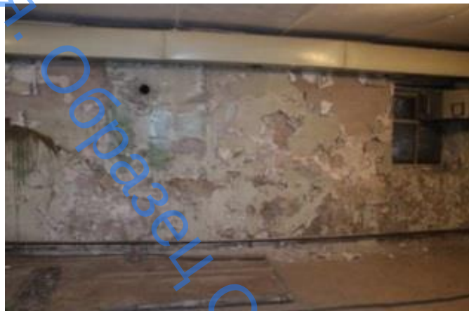
Фото 6. Следы замачивания стен подвала по оси 9
