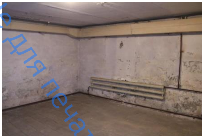
Фото 1. Следы замачивания стен подвала по оси 9
