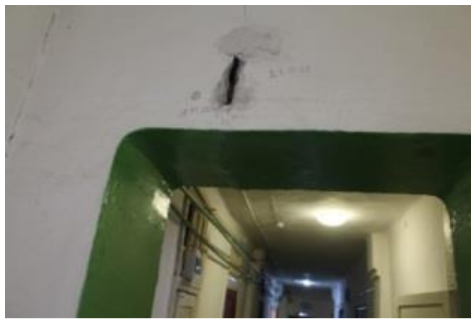
Фото 14. Трещина в стене, обеспечивающей пространственную жесткость. Ось 5, 1-й этаж
