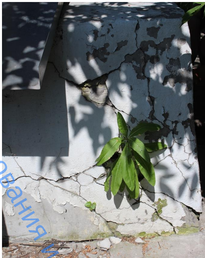
Фото 33. Трещины по отделочному слою цоколя по оси А;7
