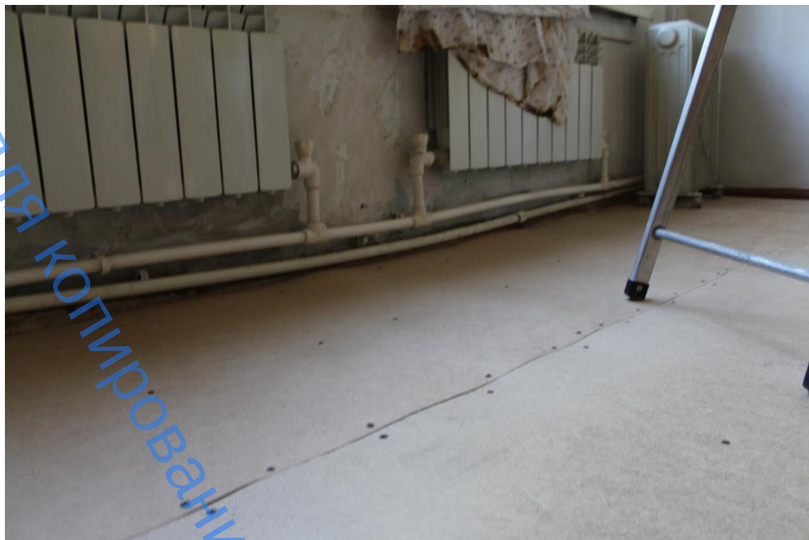
Фото 17. Искривление покрытия пола в осях В;4-5
