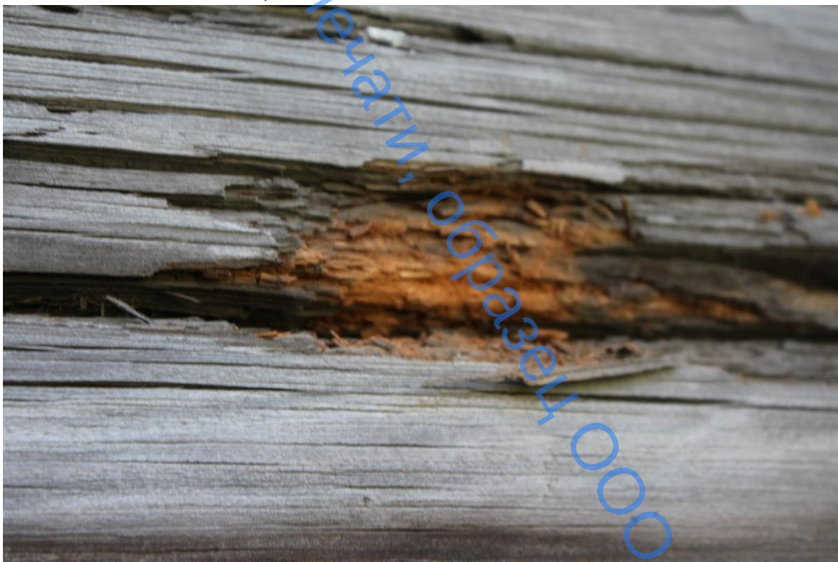
Фото 28. Поражение стен гнилью в осях В;4
