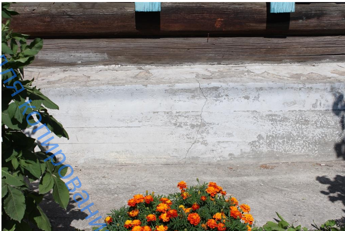
Фото 31. Трещина по цоколю в осях А;4
