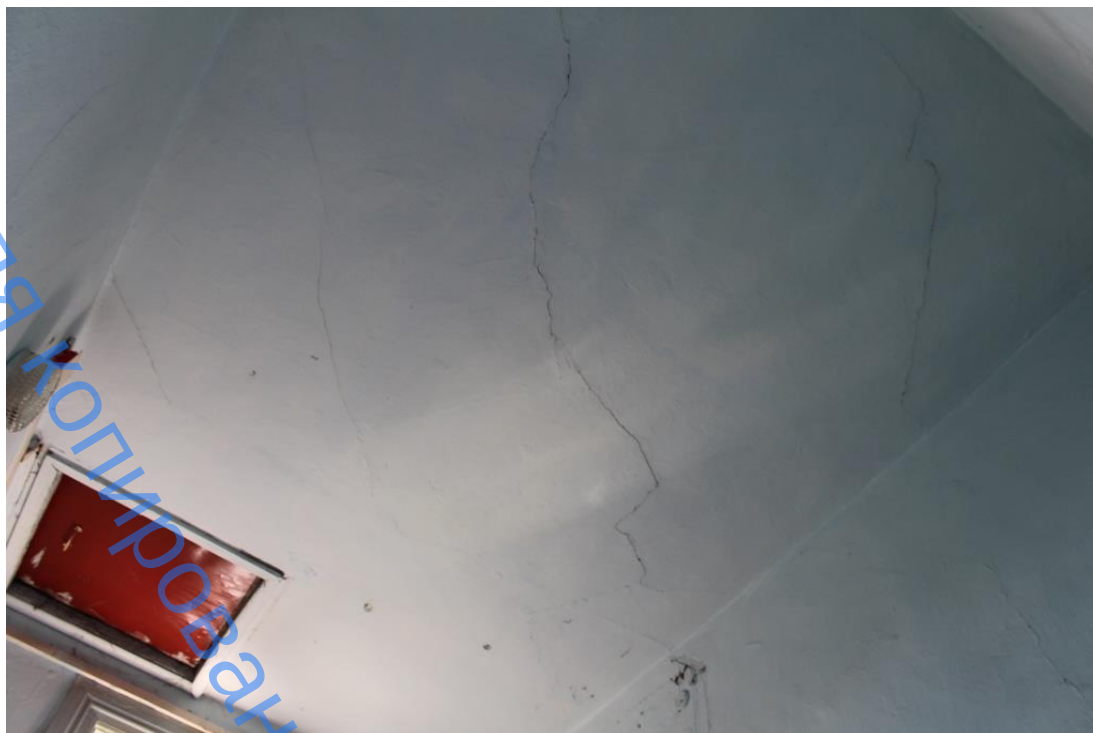
Фото 19. Трещины по чердачному перекрытию в осях А-Б,5-6
