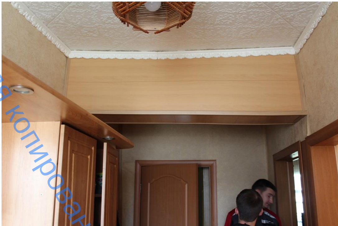
Фото 3. Прогиб перекрытия в осях Б-В;2-3
