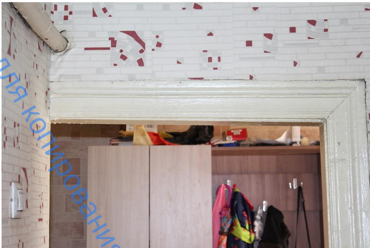
Фото 13. Перекос дверной коробки в осях А-Б;2
