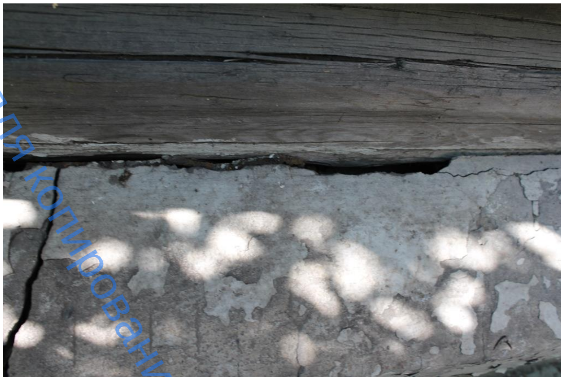
Фото 35. Трещина в месте сопряжения цоколя и стены по оси 7
