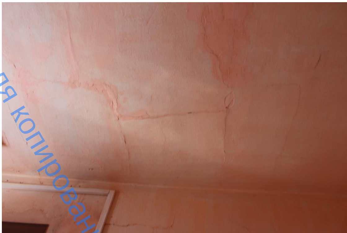
Фото 7. Трещины по чердачному перекрытию в осях Б-В;2-3
