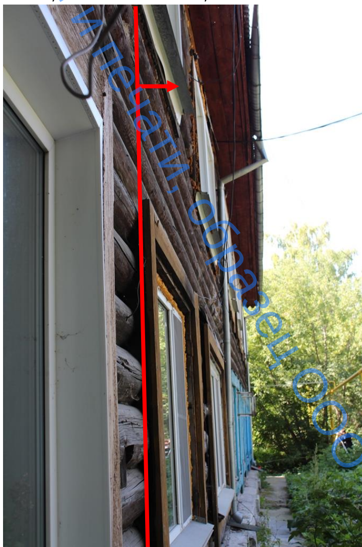
Фото 26. Отклонение стены от вертикали по оси В
