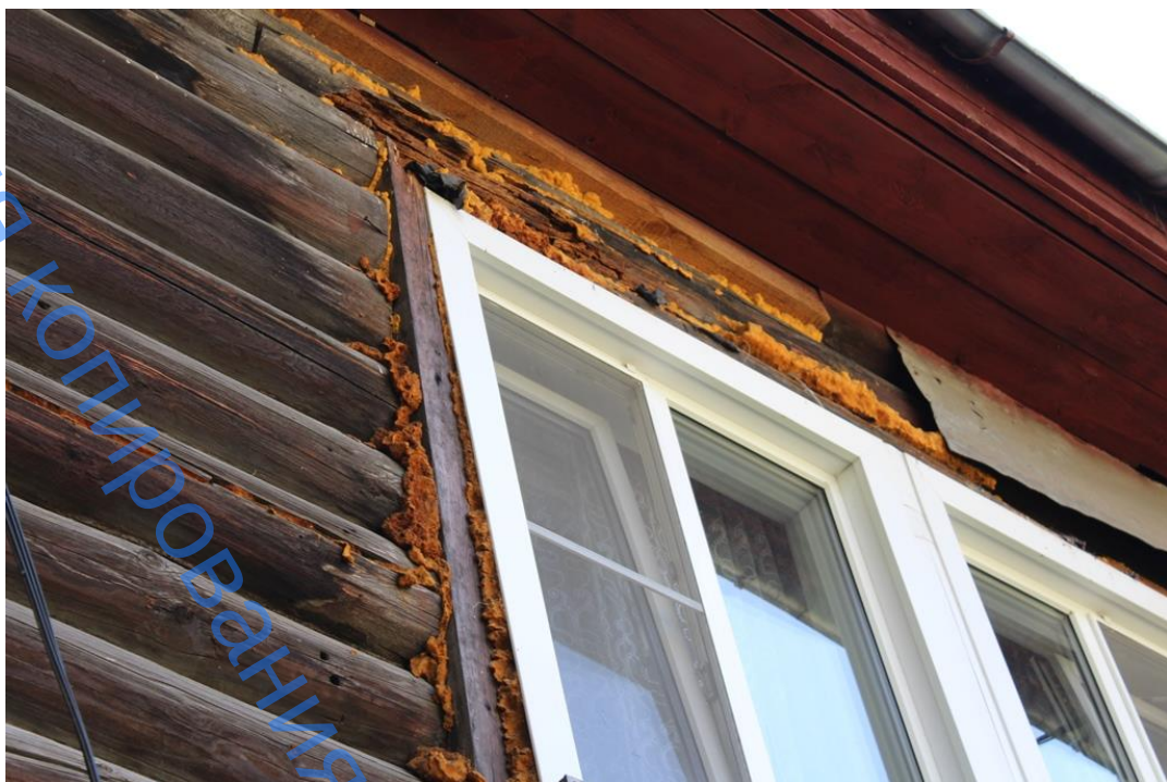
Фото 1. Фрагмент фасада по оси В. Поражение стен гнилью
