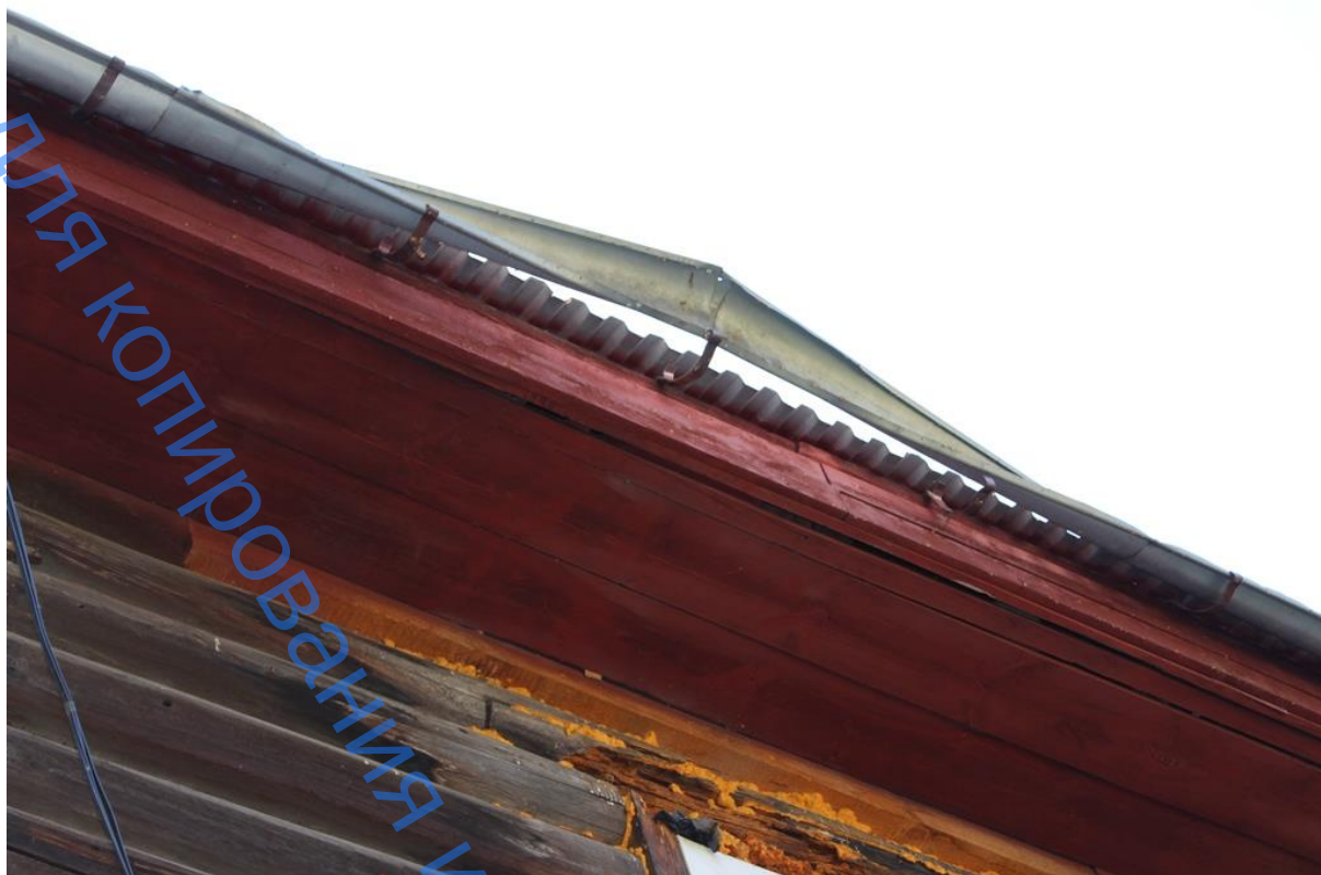
Фото 27. Искривление водосточного лотка в осях В;4-5
