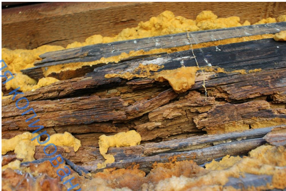
Фото 21. Гниль наружной стены в осях В;4-5
