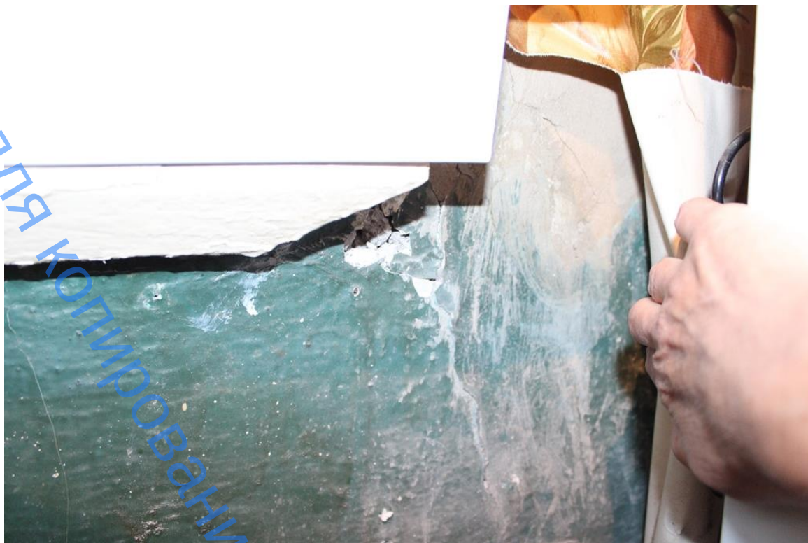
Фото 9. Трещина по стене в осях А;1-2
