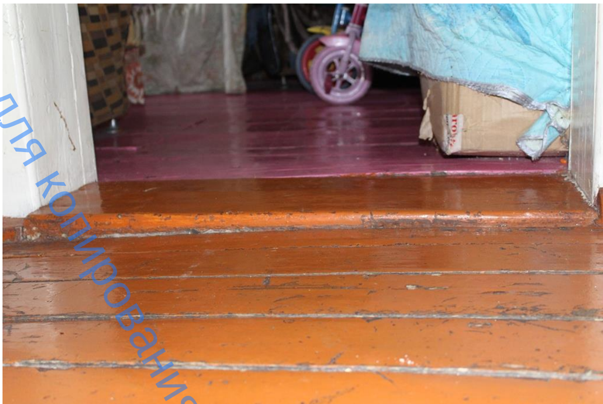
Фото 15. Уклон перекрытия в осях Б-В;2
