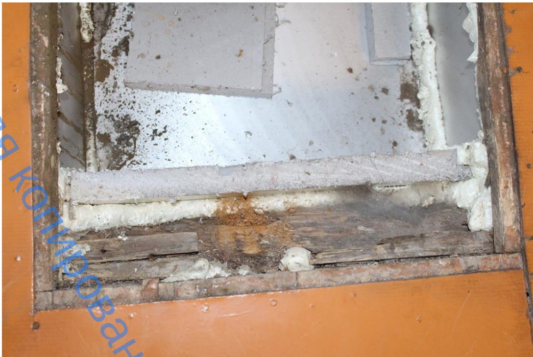
Фото 5. Поражение гнилью половых лаг в осях Б-В;З
