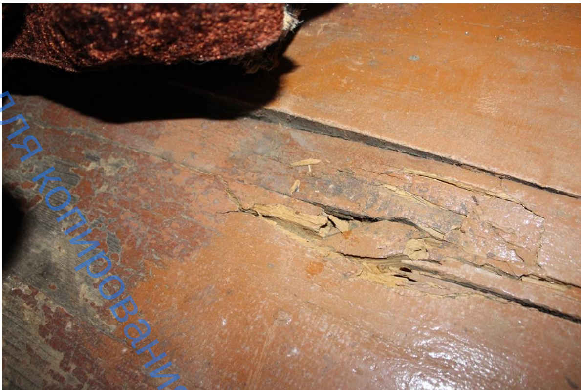
Фото 25. Поражение гнилью покрытия пола в осях Б-В,5-6
