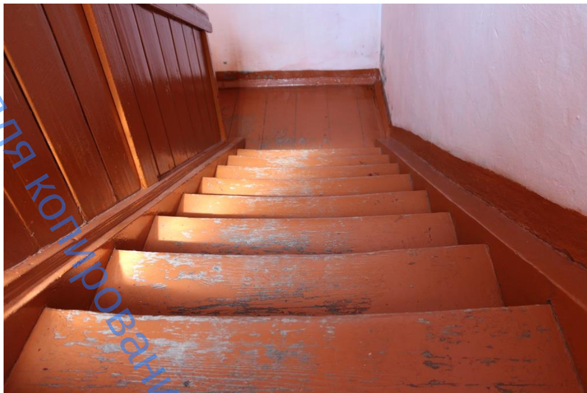
Фото 11. Истертость покрытия лестницы в осях А-Б;2-3
