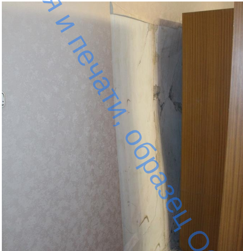
Фото 4. Неровности (провал) стены в осях Б-В;3
