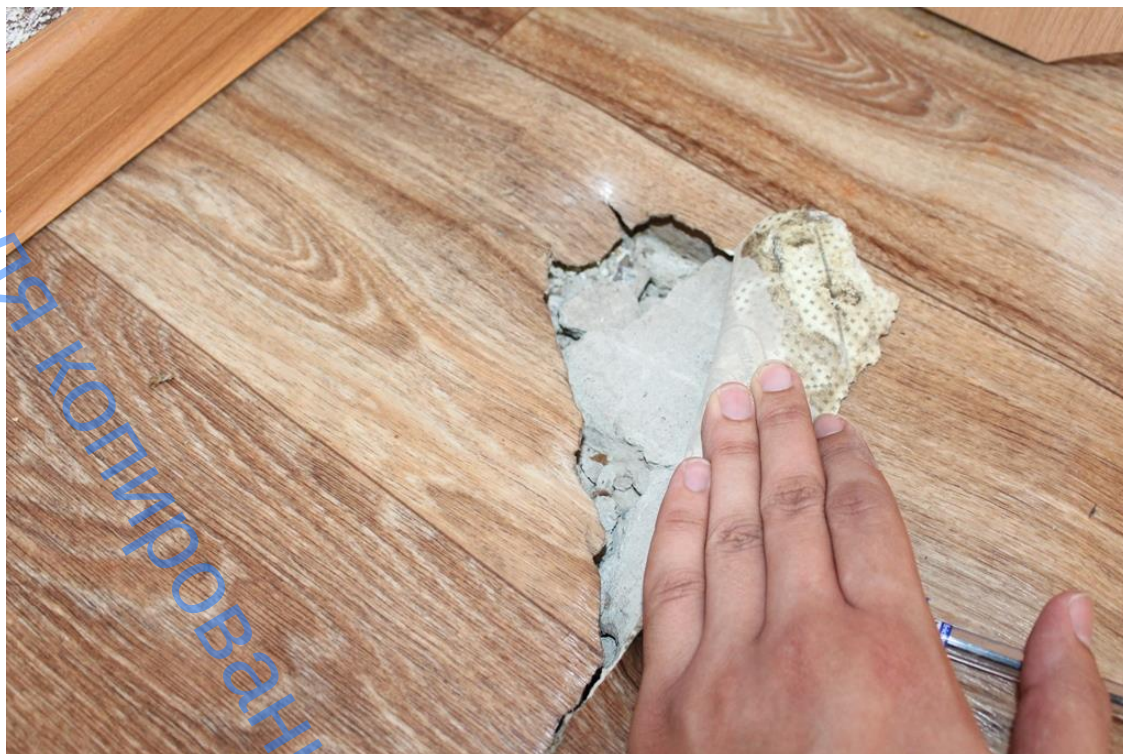
Фото 23. Частичное разрушение покрытия пола в осях А-Б,4-5
