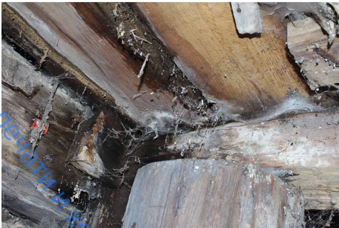
Фото 3. Поражение гнилью оголовка столбчатого фундамента, нижнего венца сруба, лаги
