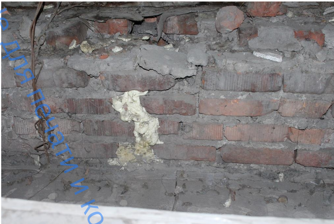
Фото 13. Трещина по оси А между осей 1 и 2 (верхний кирпичный пояс)
