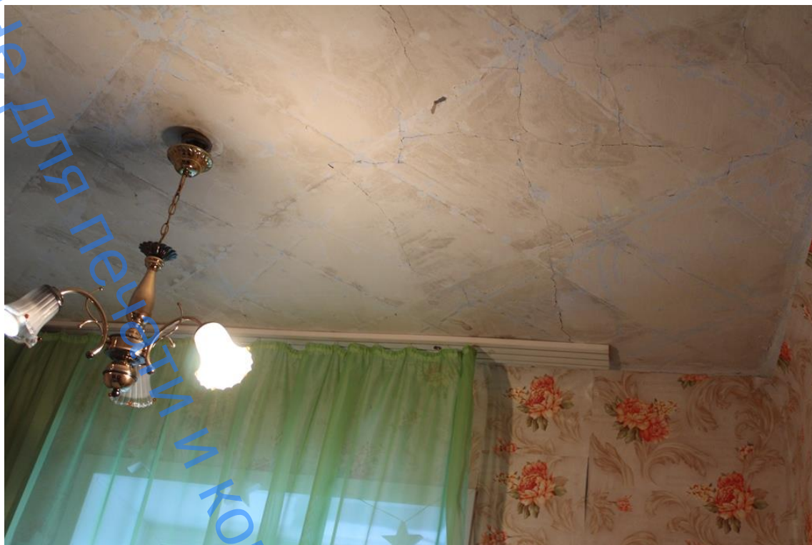
Фото 23. Перекрытие квартира 6, отпадение штукатурки
