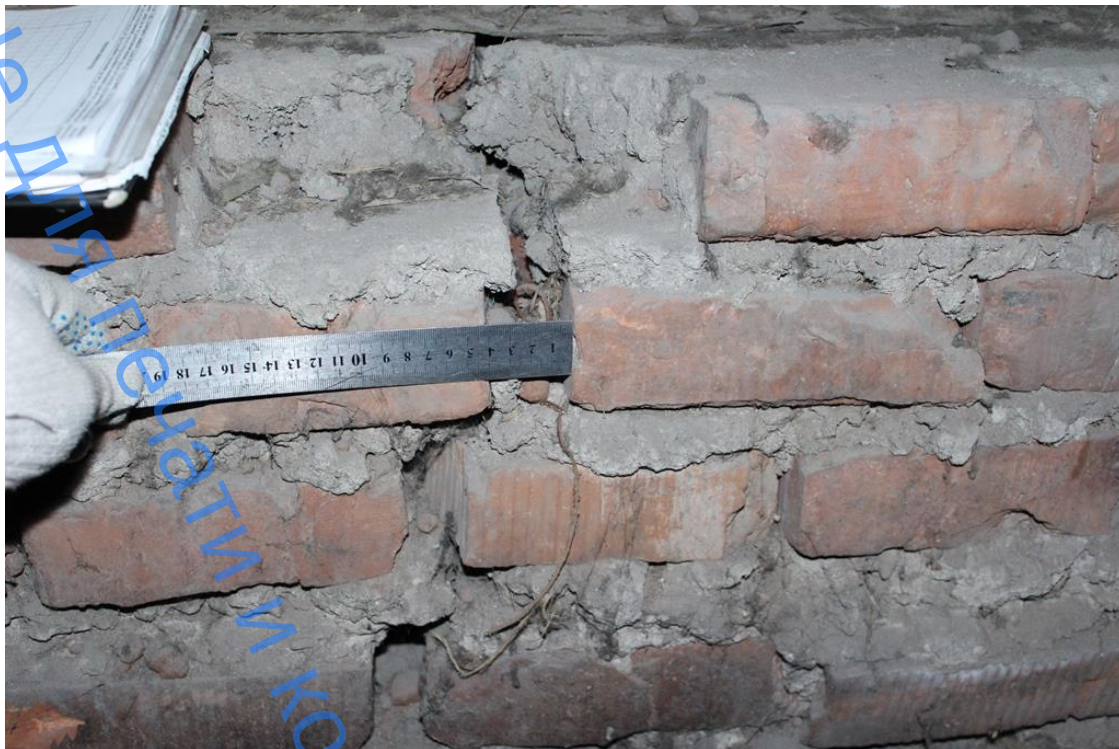
Фото 11. Трещина по оси 9 между осей В и Г (верхний кирпичный пояс)
