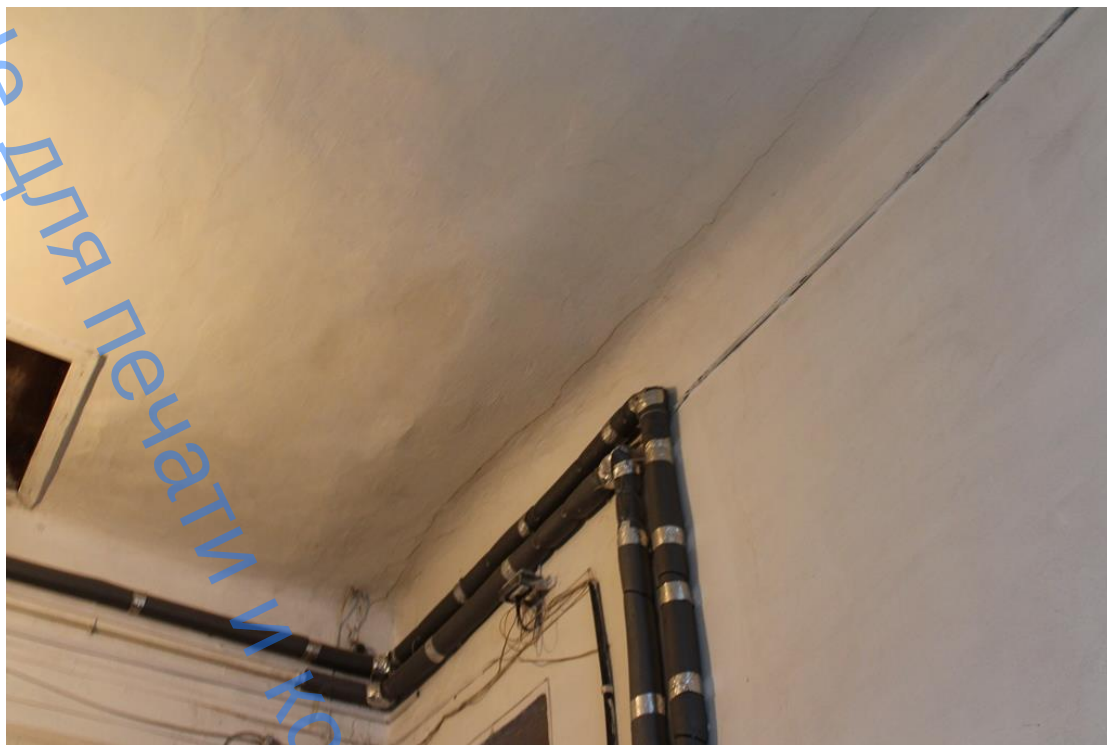
Фото 19. Перекрытие 2 подъезда (трещина вдоль раскладки балок), створ трещины между осей 1 и 2.
