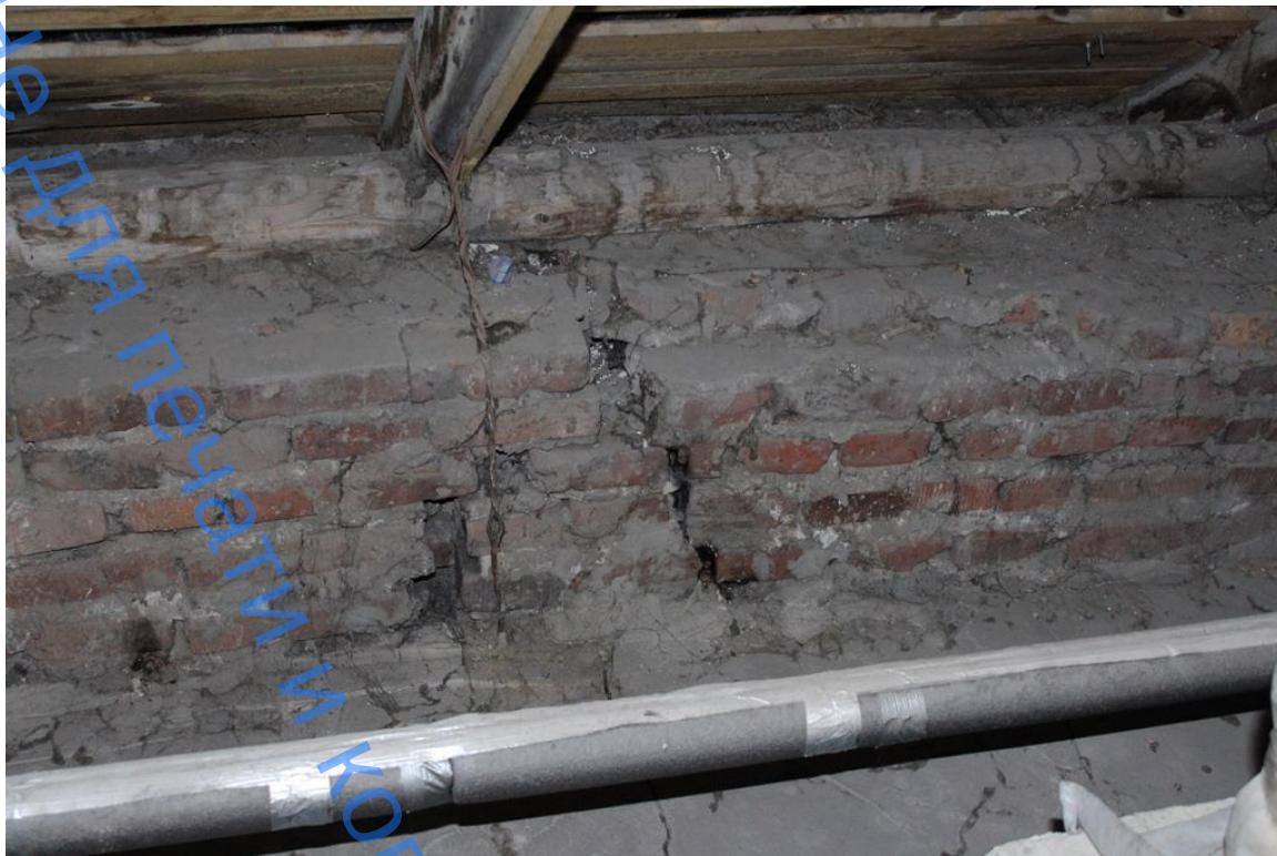
Фото 15. Трещина по оси В между осей 1 и 2 (верхний кирпичный пояс)
