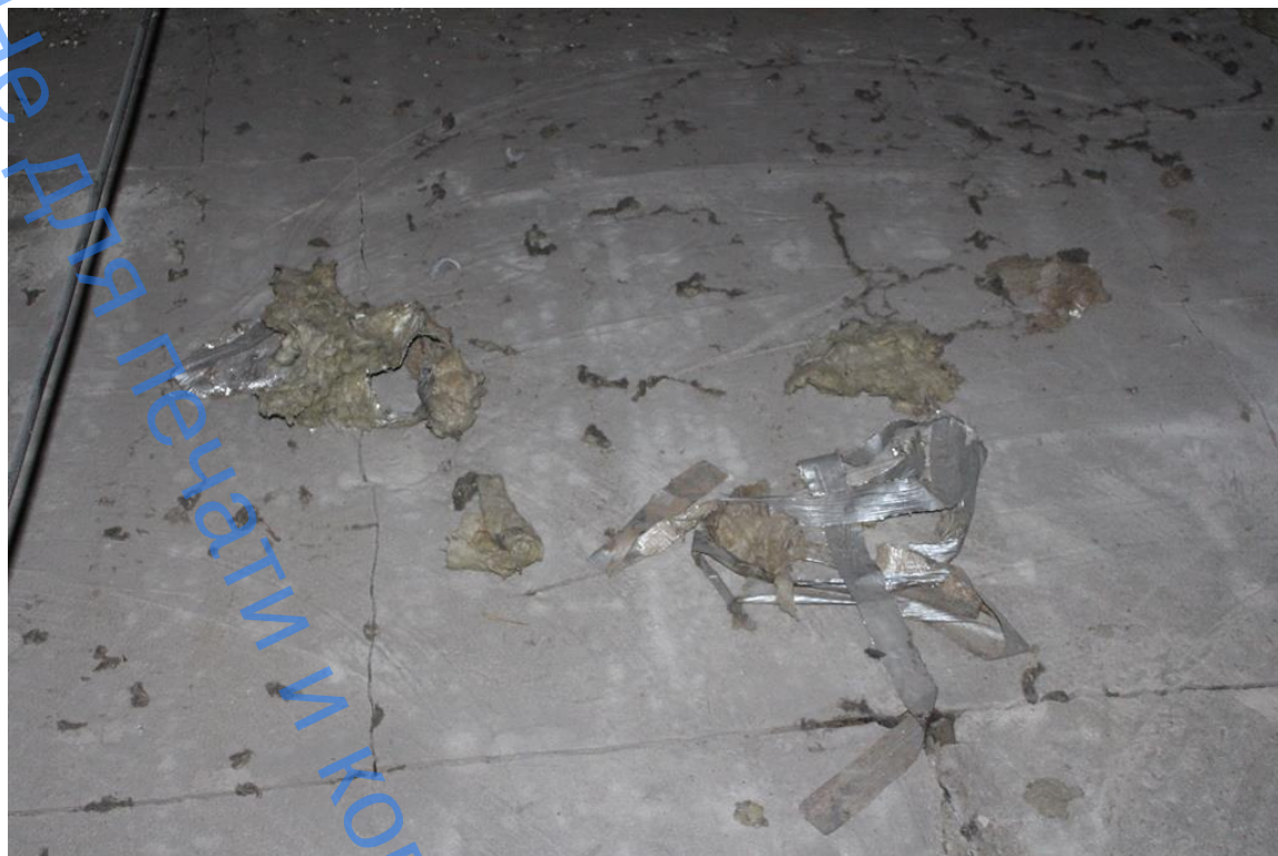
Фото 25. Трещины по стяжке.
