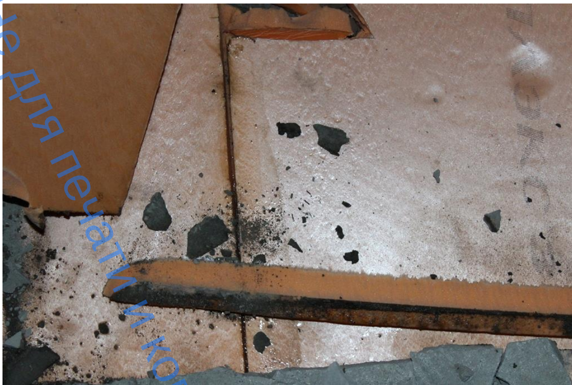
Фото 27. Плесень, влага в утеплителе.
