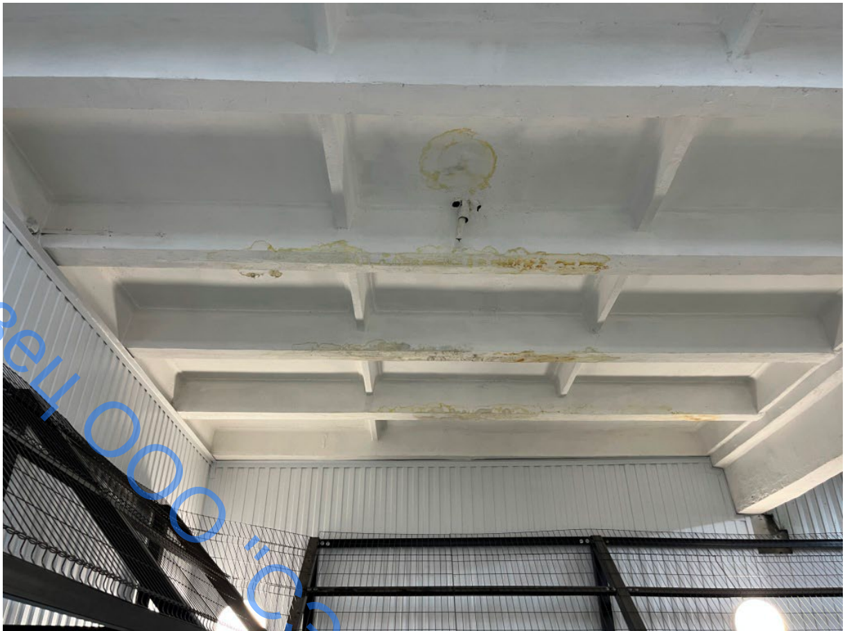
Фото 19. Замачивания, высолы на поверхности бетона, шелушение поверхности бетона плит перекрытия 1-го этажа в осях 5-6/Б-В
