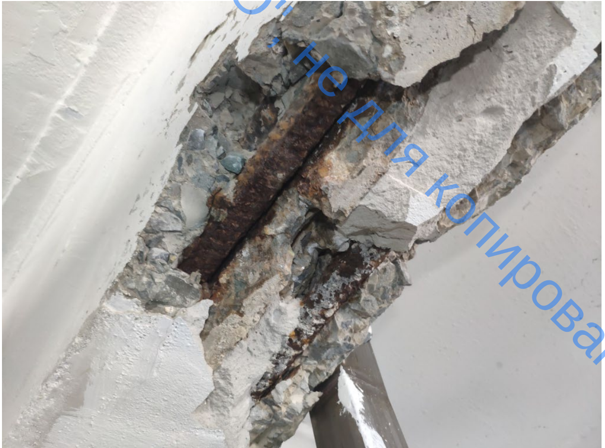
Фото 30. Коррозионные повреждения стержней рабочей арматуры плит перекрытия 2-го этажа под ремонтными составами
