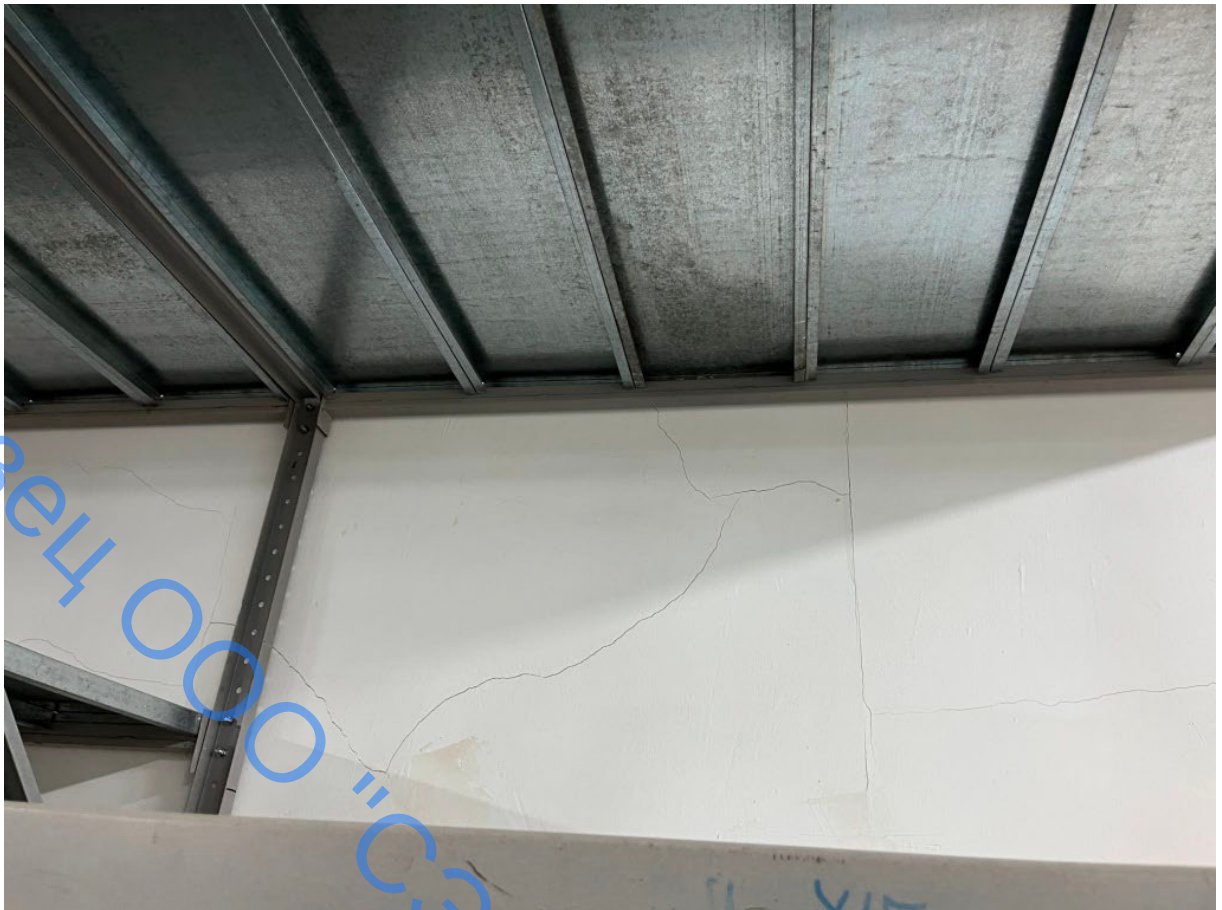
Фото 11. Сеть мелких трещин в штукатурном слое перегородок в осях 3-6/Б-Г
