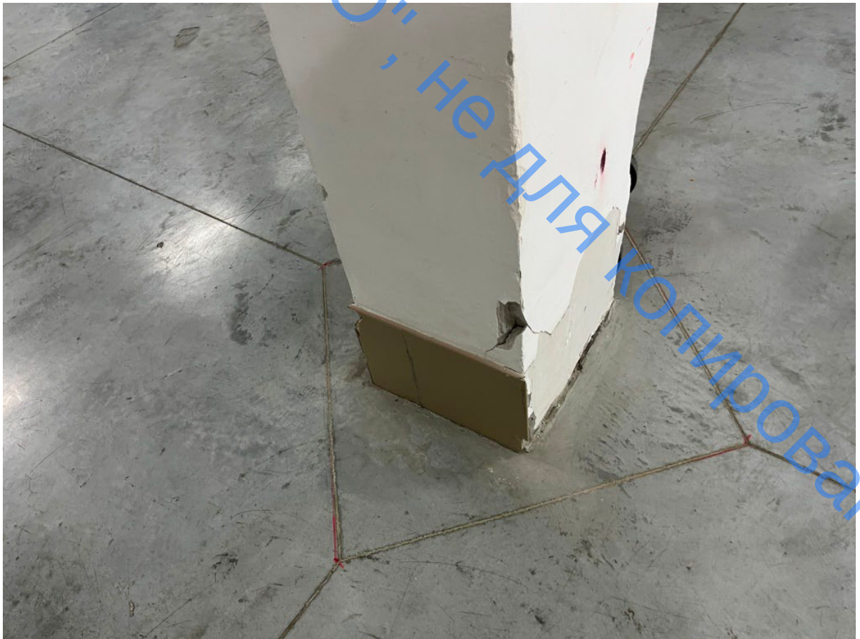
Фото 12. Механическое повреждение штукатурного слоя колонны каркаса в осях 4/В
