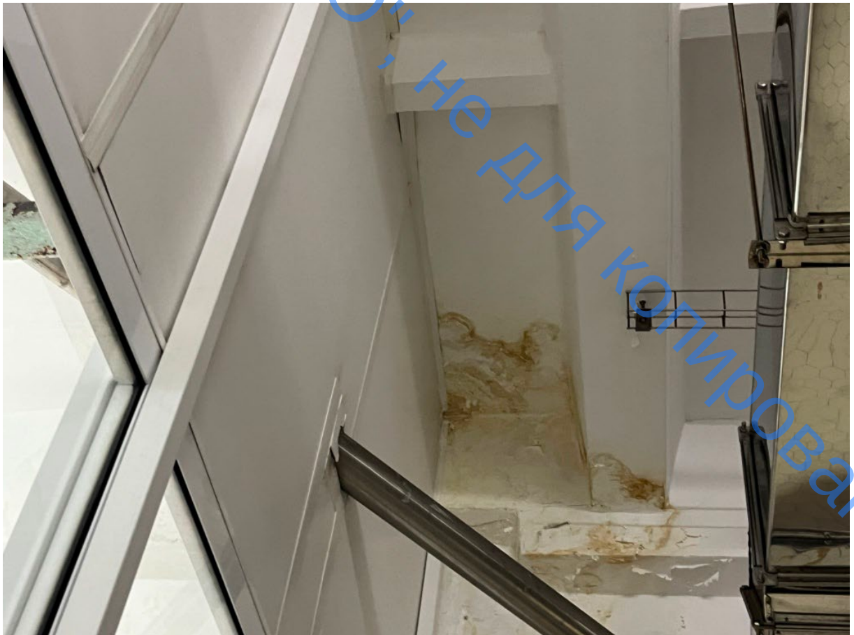
Фото 14. Замачивания, высолы на поверхности бетона, шелушение поверхности бетона конструкций перекрытия 2-го этажа в осях 3/Г
