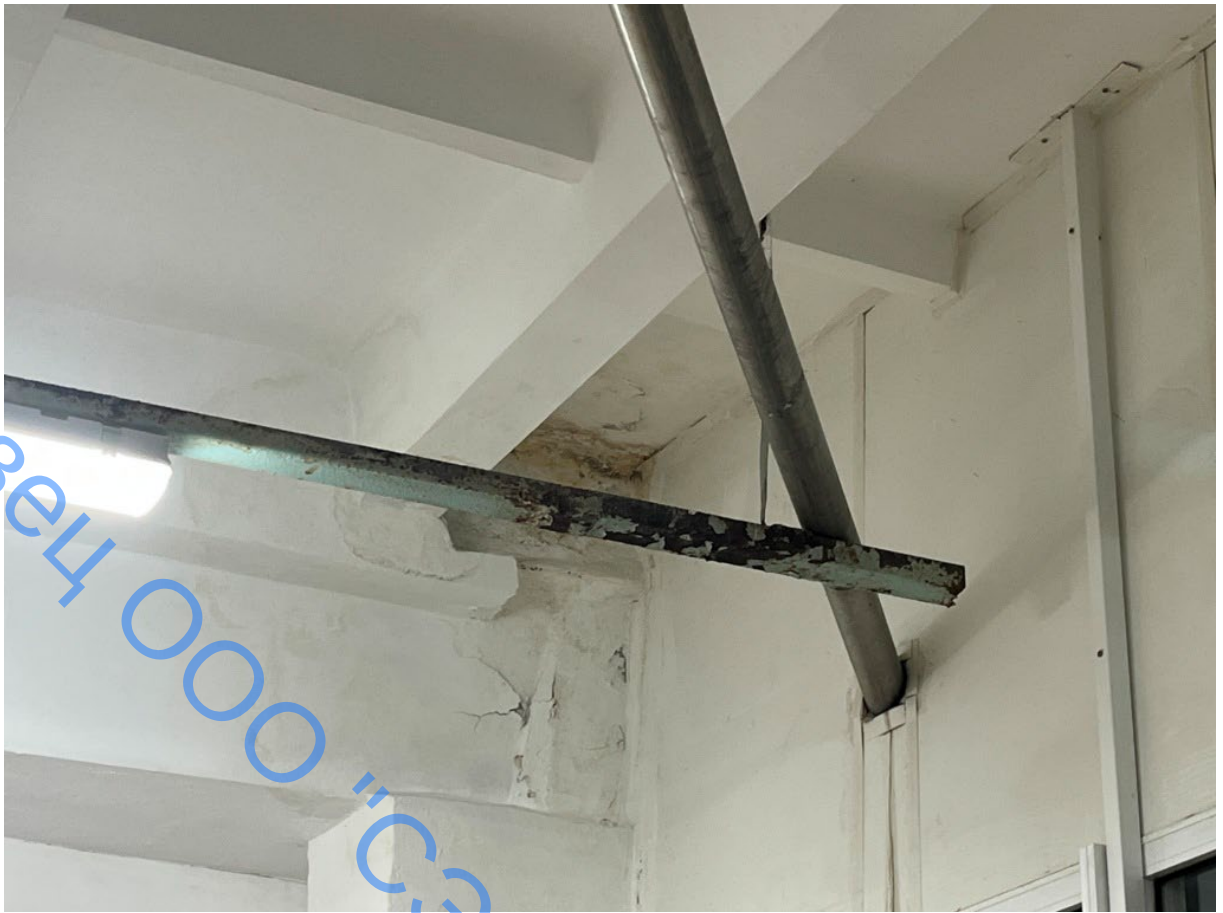
Фото 15. Замачивания, высолы на поверхности бетона, шелушение поверхности бетона конструкций перекрытия 2-го этажа в осях 3/Г
