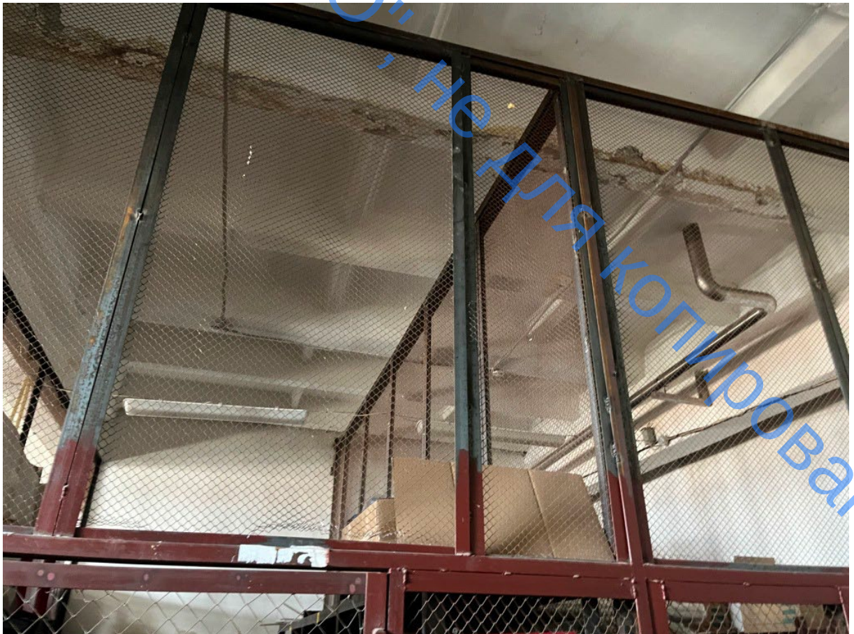
Фото 6. Замачивания, высолы на поверхности бетона, шелушение поверхности бетона плит перекрытия 2-го этажа в осях 2-3/В-Г
