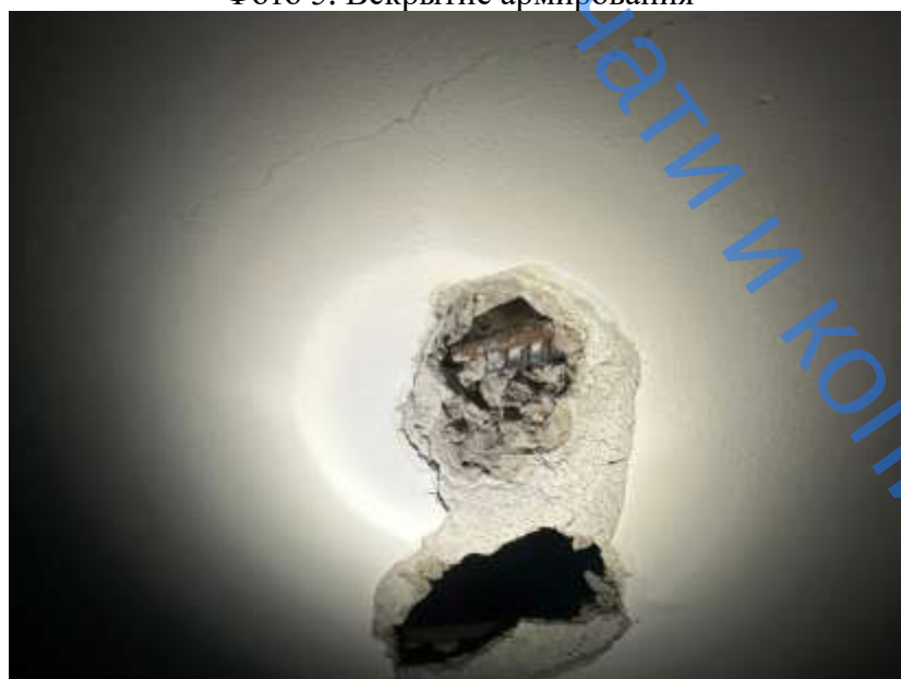
Фото 6. Вскрытие армирования из квартиры ниже
