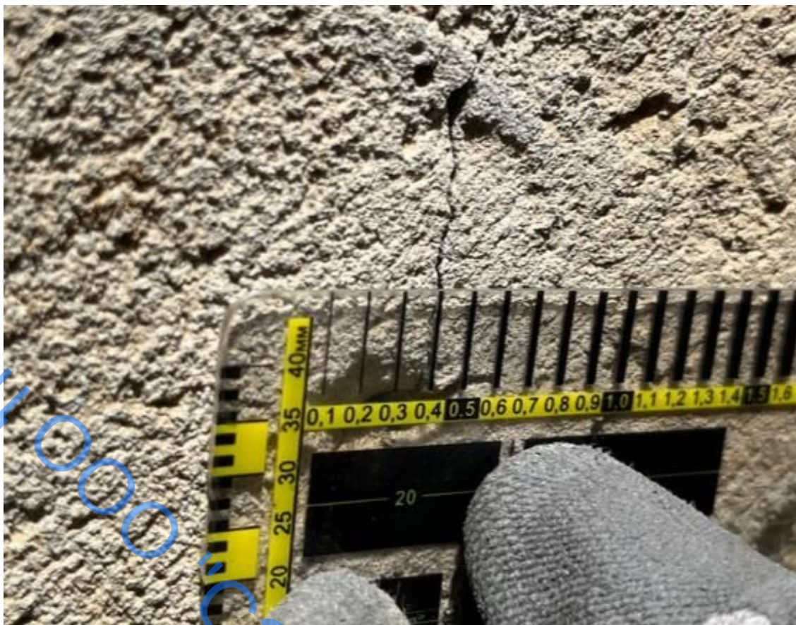
Фото №13.1 — Крупный план трещины на фото 13
