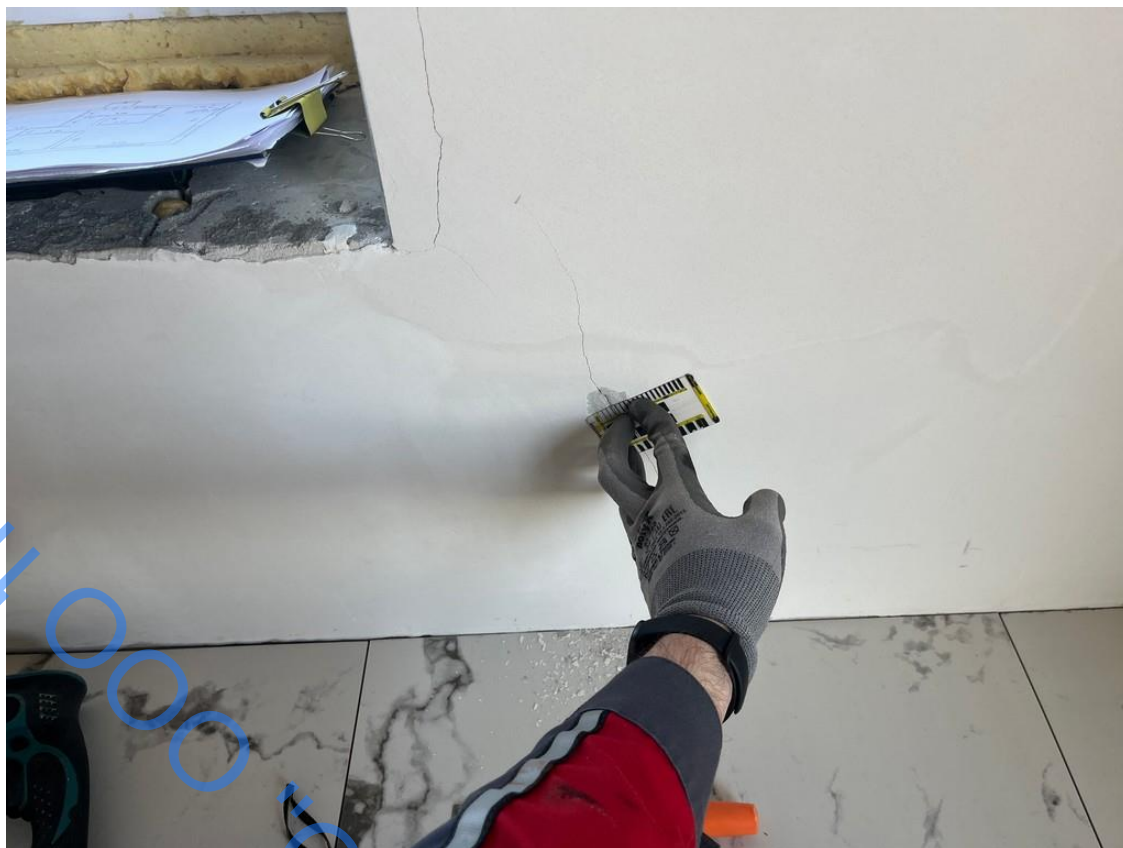
Фото №8 – Трещина в наружной стене
