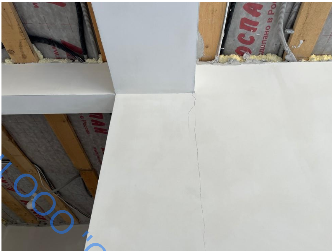
Фото №16 – Трещина в стыке перегородки и внутренней несущей стены
