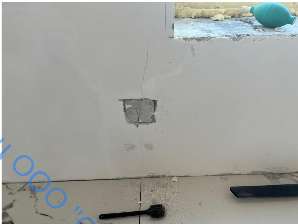
Фото №6 – Трещина в наружной стене
