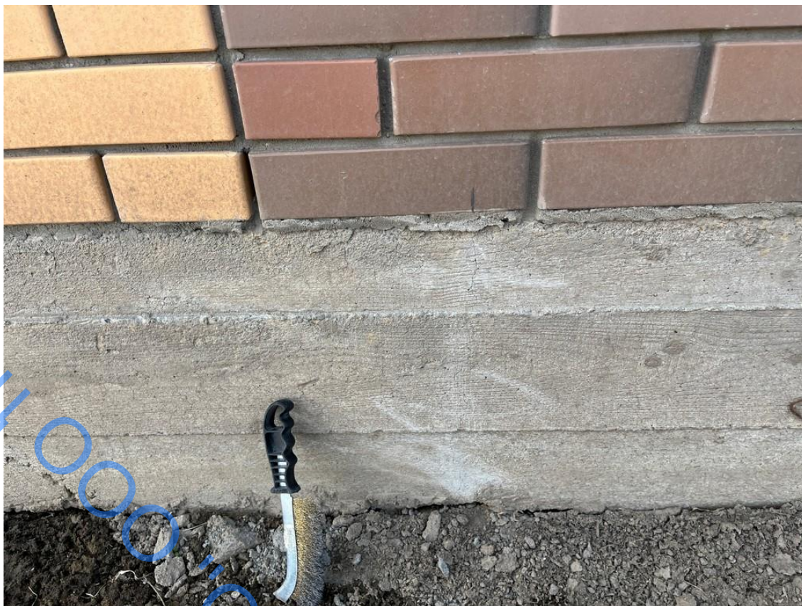
Фото №9 – Трещина в ростверке
