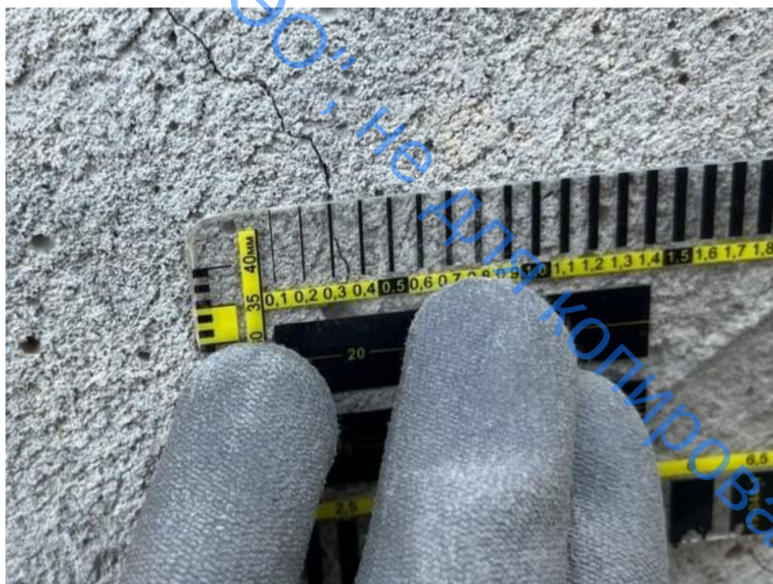
Фото №7.1 – Крупный план трещины на фото 7
