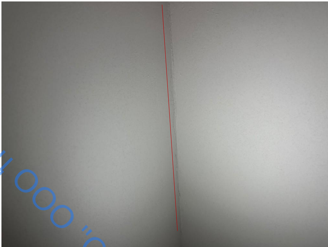
Фото №10 – Трещина в наружной стене
