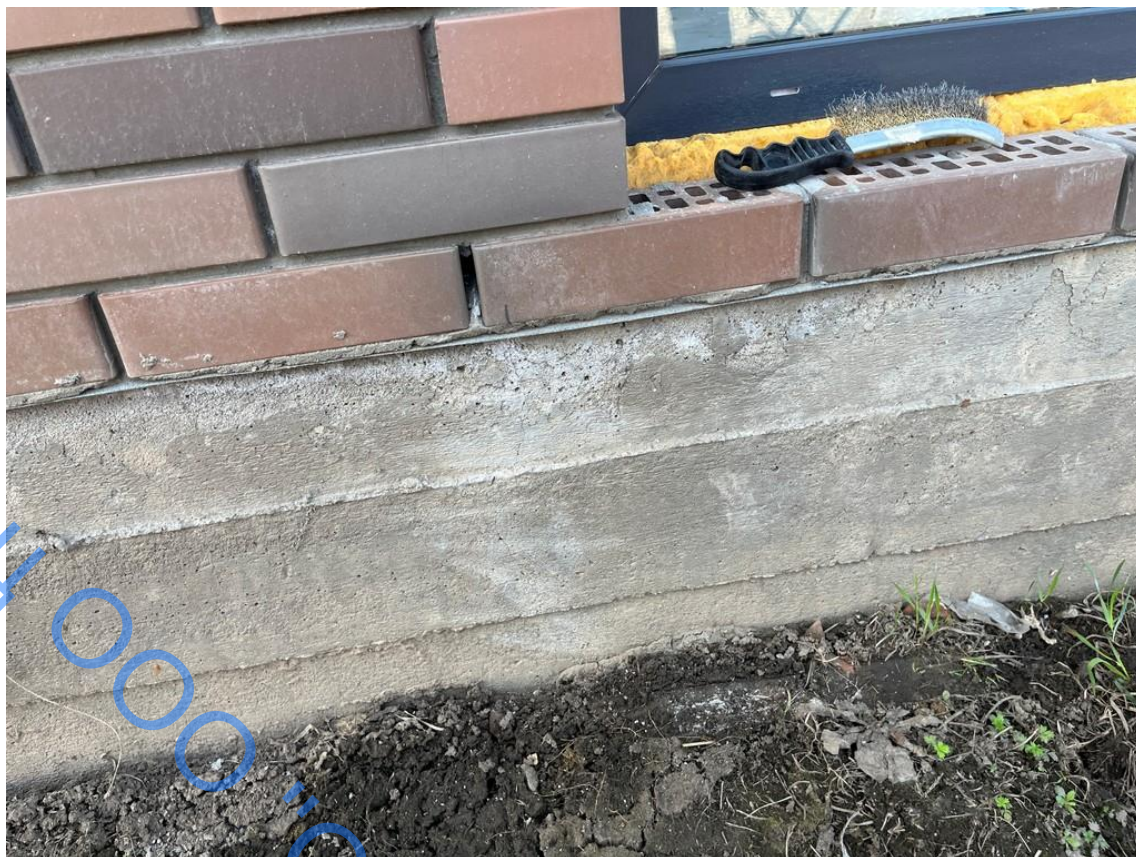
Фото №19 – Трещина в ростверке
