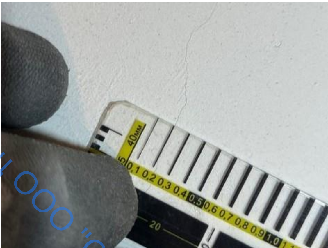
Фото №14.1 — Крупный план трещины на фото 14
