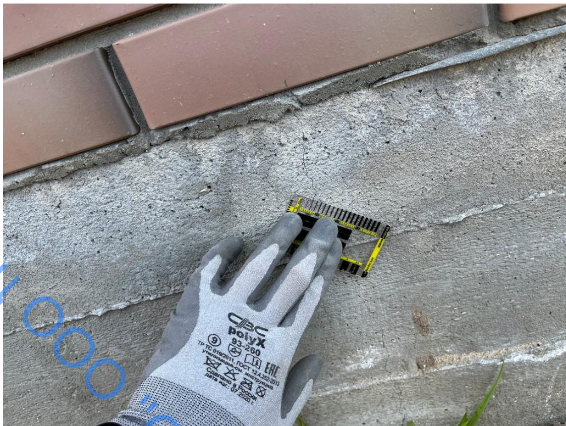
Фото №7 – Трещина в ростверке
