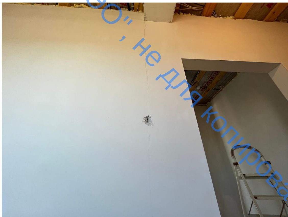
Фото №15 — Трещина в стыке перегородки и внутренней несущей стены
