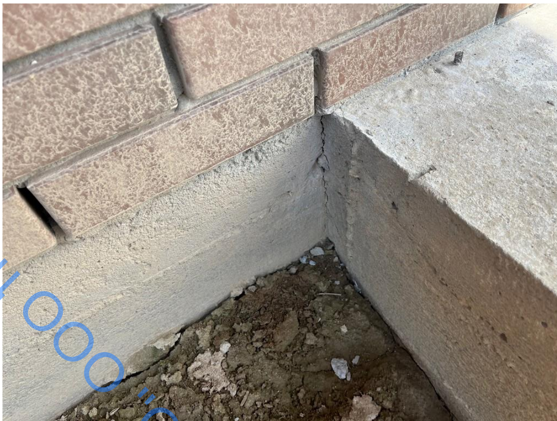
Фото №17 – Трещина в ростверке
