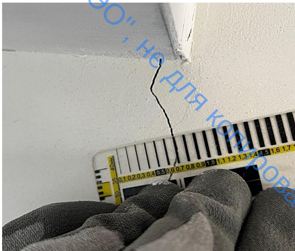
Фото №16.1 – Крупный план трещины на фото 16
