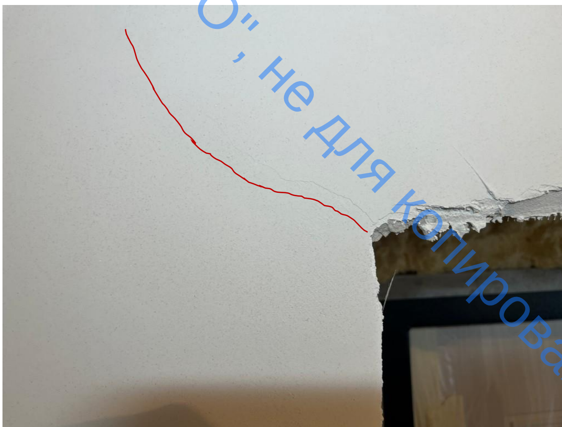
Фото №14 — Трещина в наружной стене
