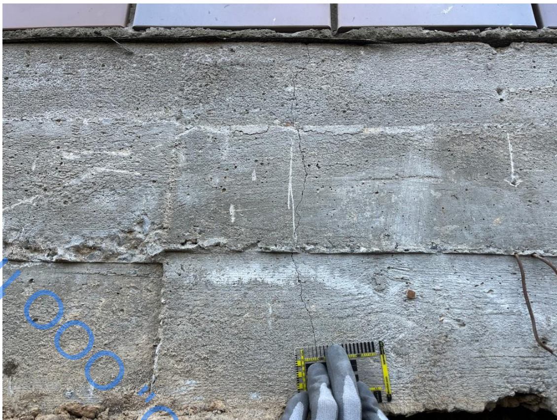
Фото №5 – Трещина в ростверке
