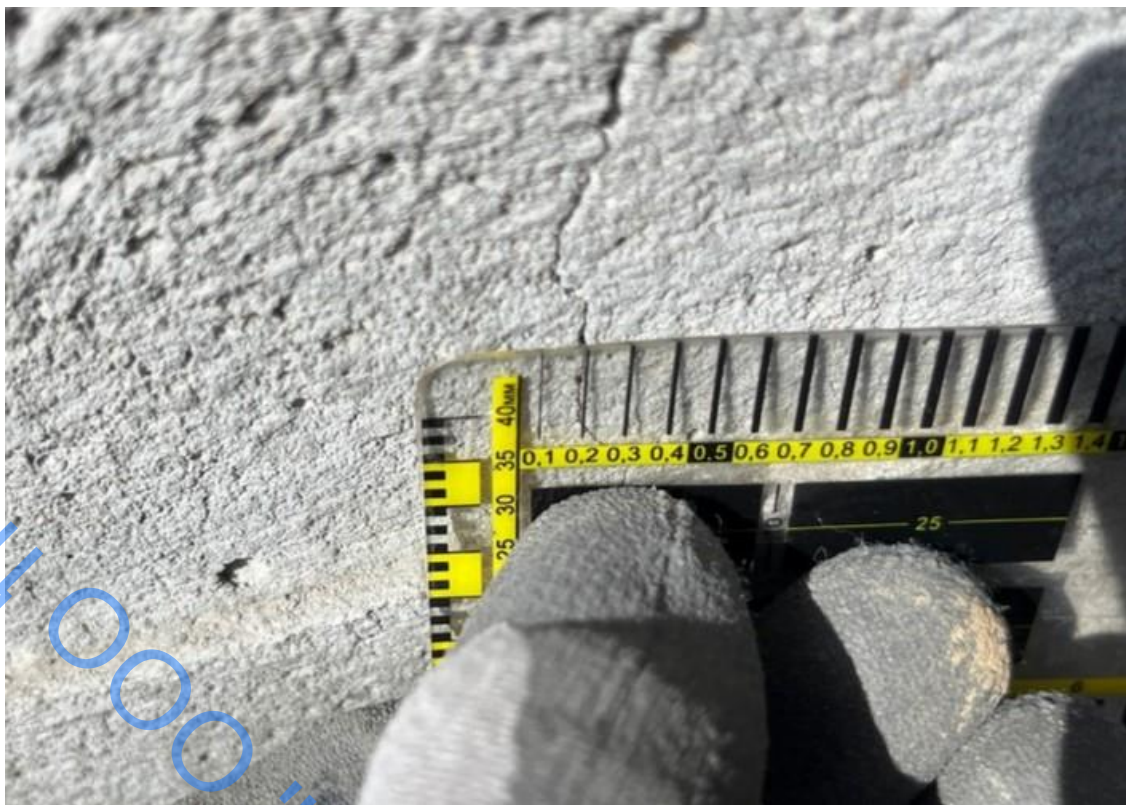
Фото №11.1 – Крупный план трещины на фото 11
